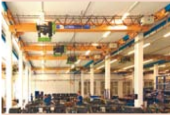
Einträgerhängekran (Stahl Crane Systems)
